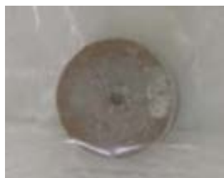
図1 コンクリート コア外観 (4RB-1F-C-E2)
