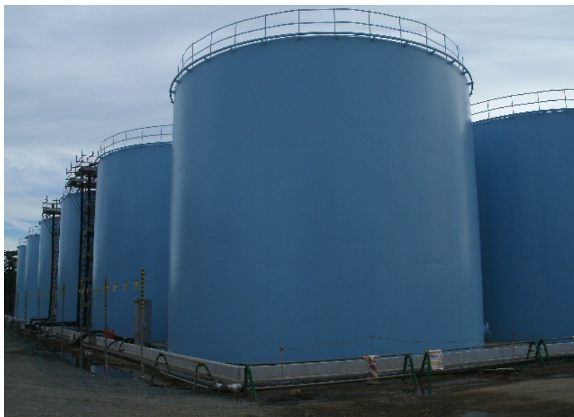
溶接型タンク
