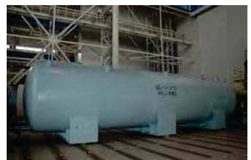
廃スラッジ一時保管施設貯槽 *2
