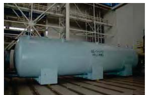
廃スラッジ一時保管施設貯槽 *2
