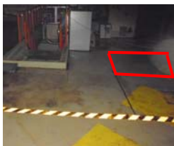
①床面 コンクリート塗装面 (水除染済みだが、 固着性汚染のある部位)
