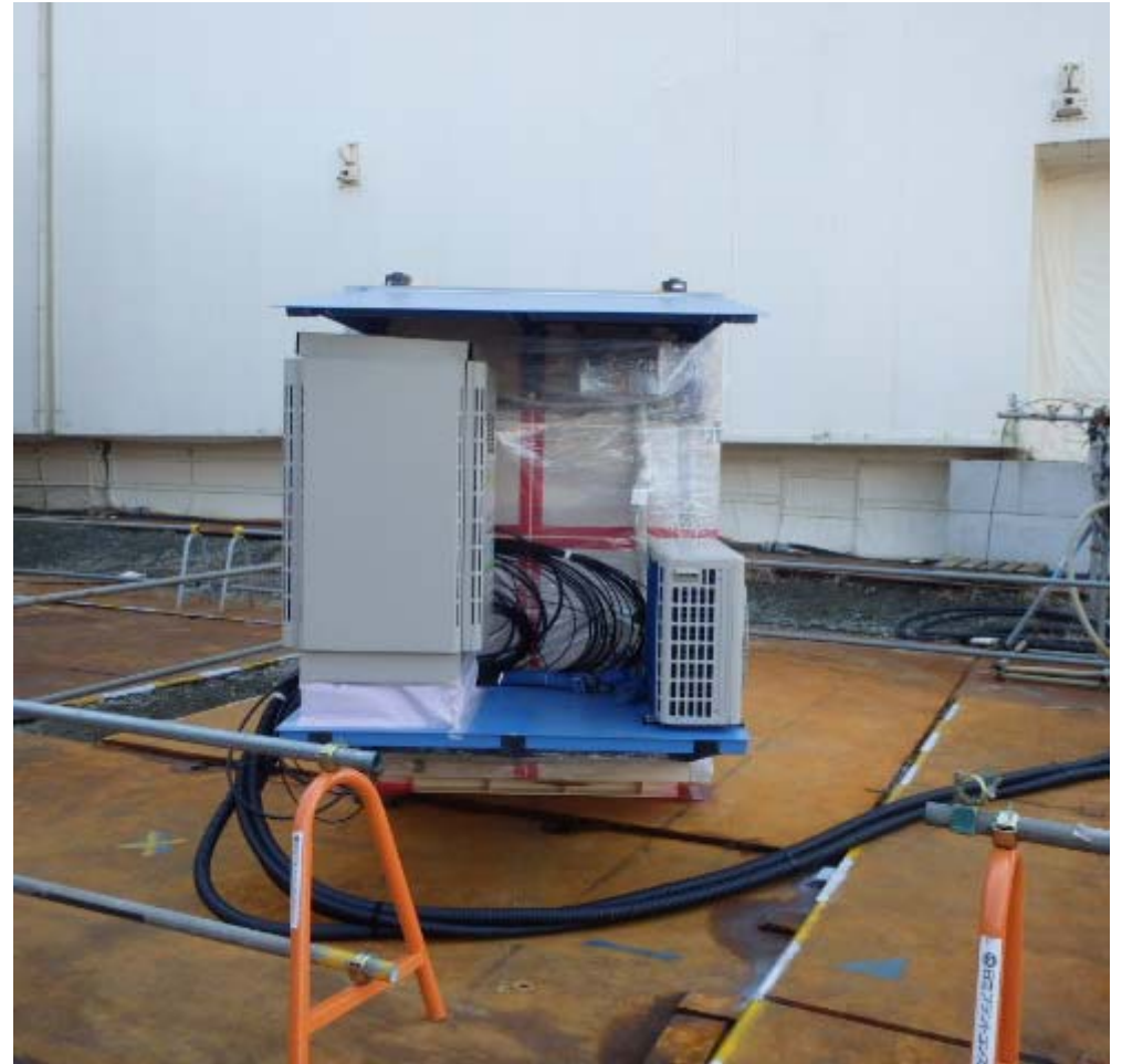
写真6 設置完了後の測定装置2(北側)
