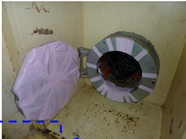
2号機X6ペネ定検時の状況写真
