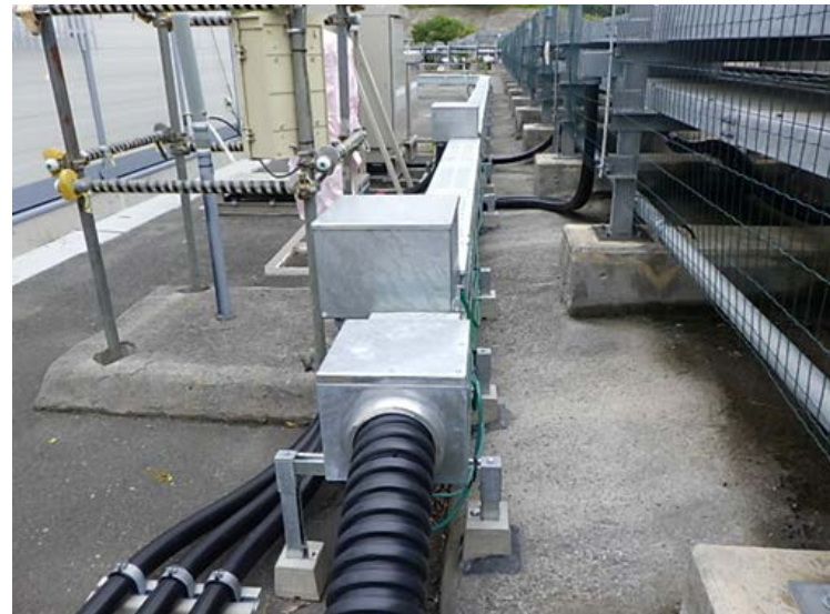
図4.5-7 コントロールルーム電路
