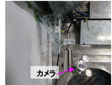
カメラ(天井設置)
