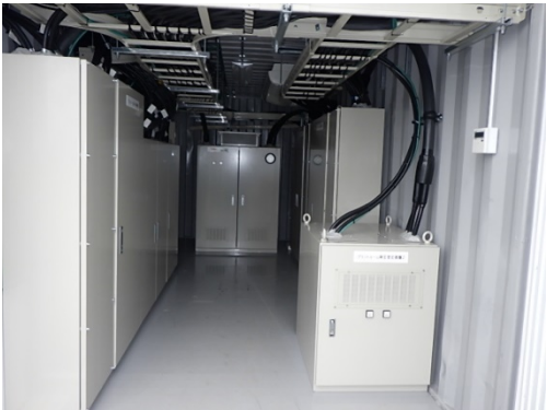
図4.5-4 : B視 プラントルーム1内部
