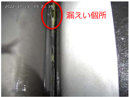
ハッチ隔離部屋 漏えい箇所
