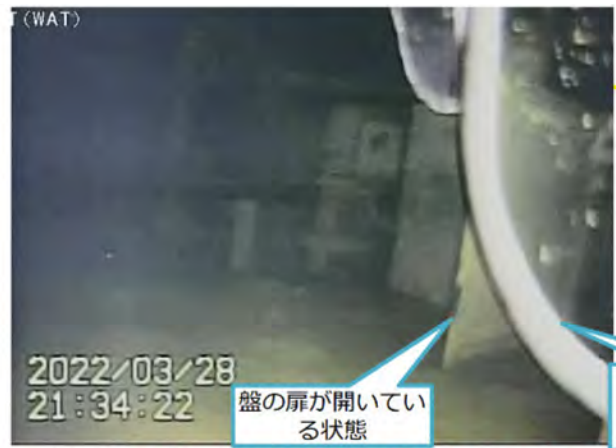
写真1.ペDESTAL外壁に設置されている盤※
