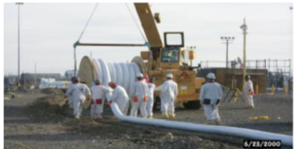
図1 スラッジ輸送に使用された Hose-in-Hose 注1
