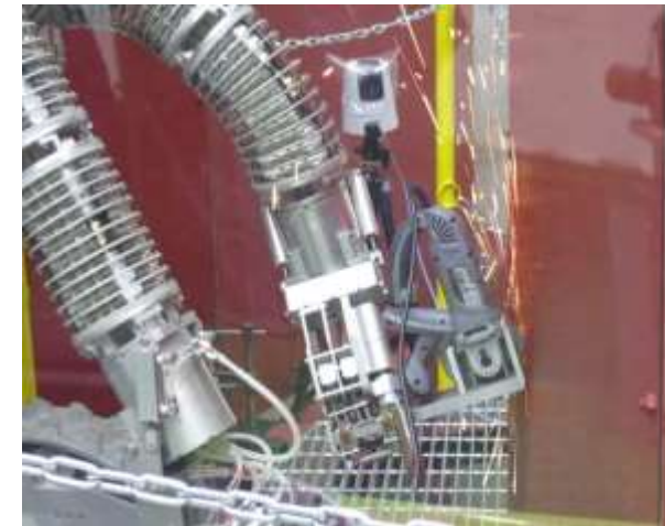
垂直方向切断状況
