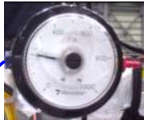
DSP(シート内)負圧管理 (-200Pa)
