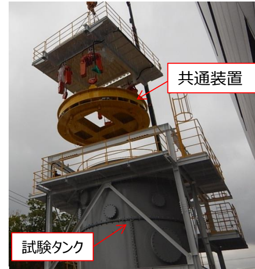
1/1試験模擬設備
