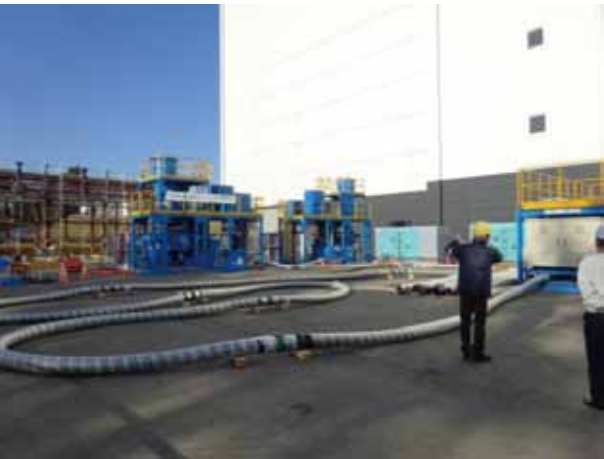
写真2 S/C脚部補の補強材料供給設備(屋外)
