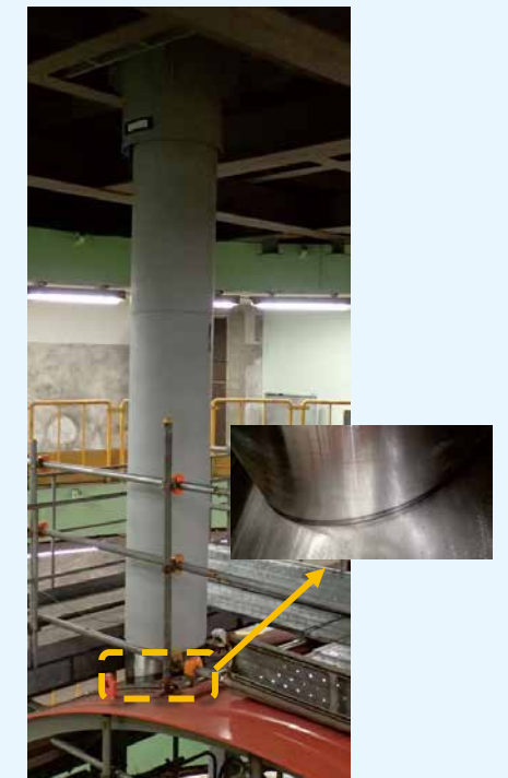
図4 延長配管とS/Cの接続状況
