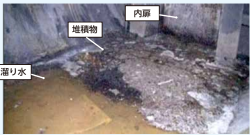
図2 エアロック室内の堆積物・溜水
