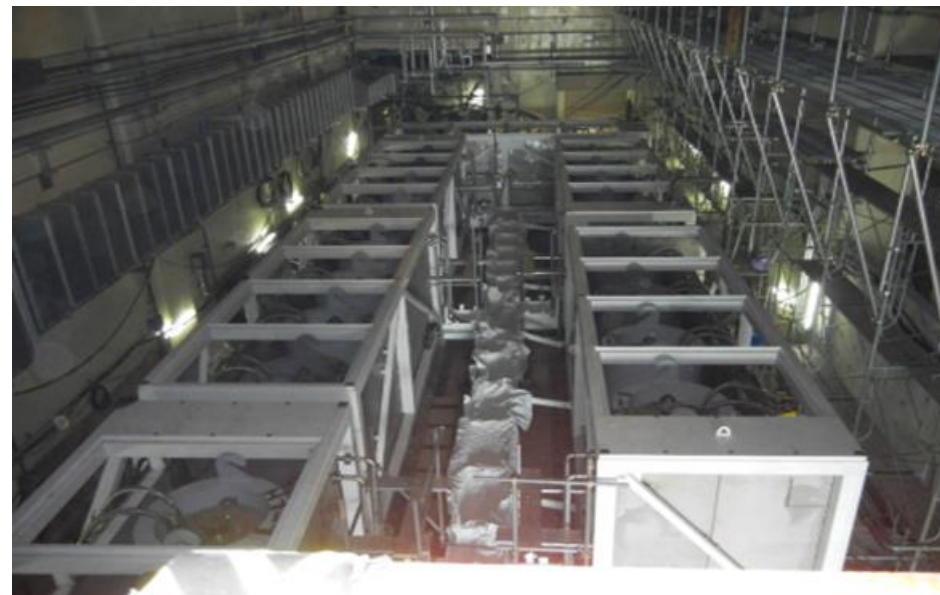
セシウム吸着装置外観
