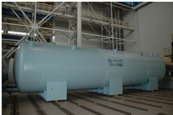
廃スラッジ一時保管施設貯槽
