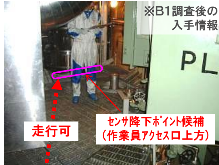
定検時(事故前)の写真(A)
