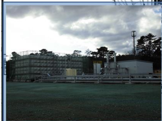
昇温・給水設備
