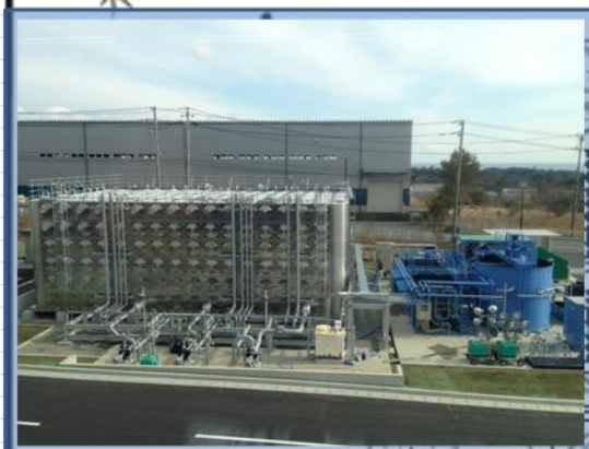
濁水処理設備
