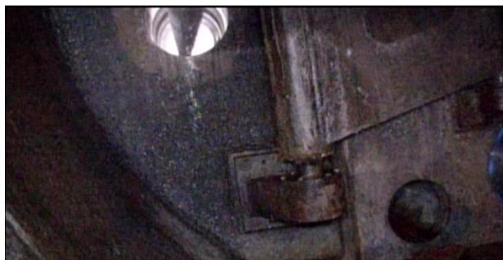
X-2ペネ外扉の状況 (B方向から撮影)
