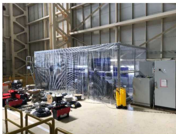
コントロールルーム設置状況
