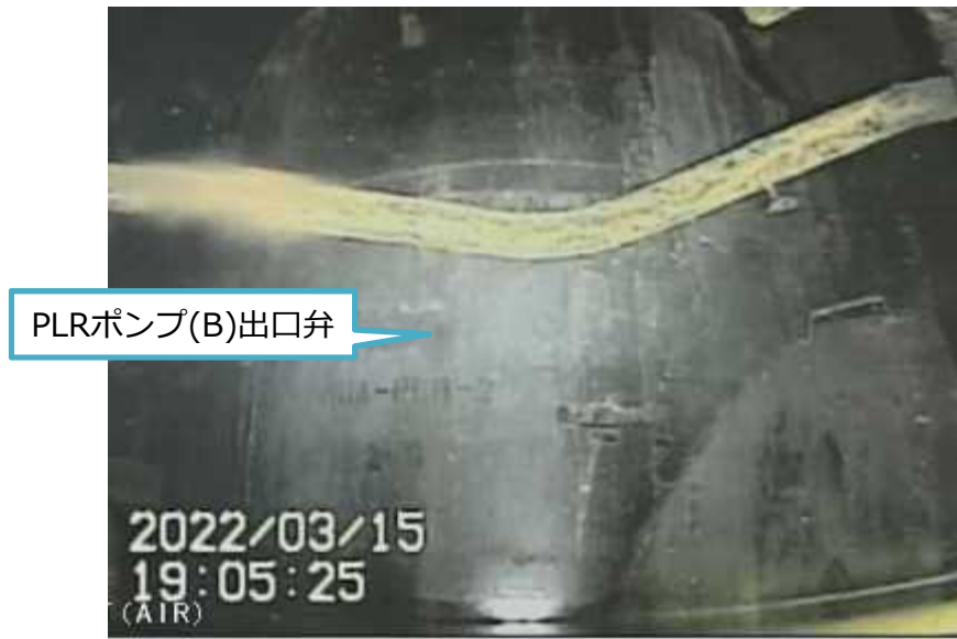
写真1. PLRポンプ(B)出口弁付近の状況
