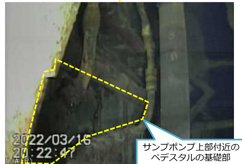
写真3.ペデスタル基礎部付近の状況②
