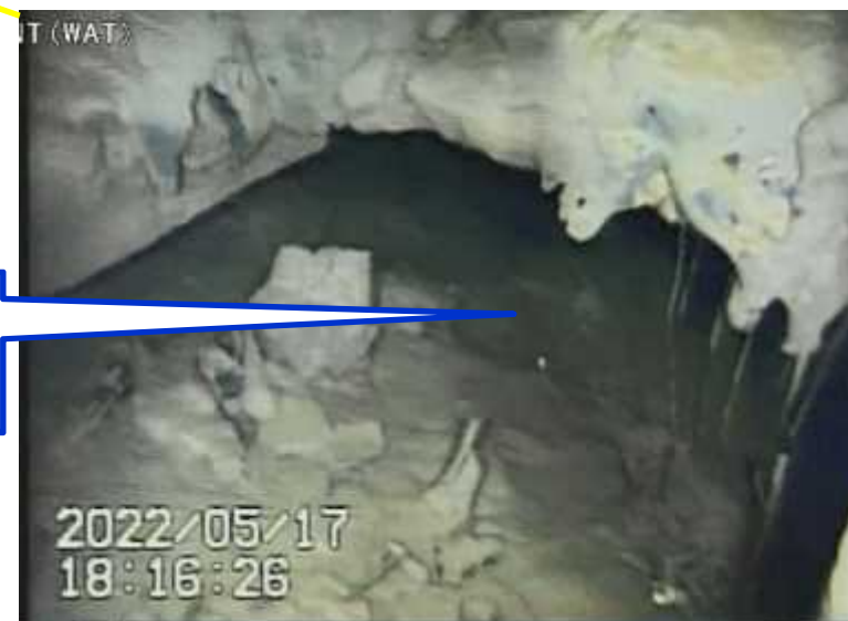
写真3.PCV底部の堆積物の状況(空洞内部)
