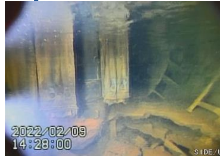
PLR配管付近
