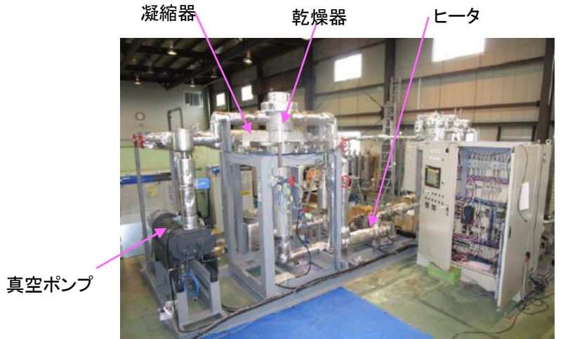
実規模乾燥試験装置 外観
