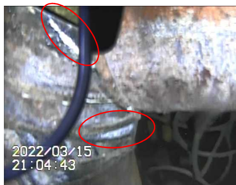
格納容器貫通部付近で確認された RCW配管への光沢のある付着物（水中）
