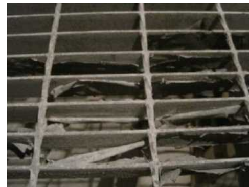
福島第二4号機で確認された グレーチングからの亜鉛塗料の剥離 (推定される環境温度 ~150°C)
