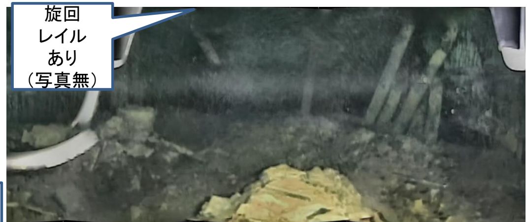
写真1. 1号機のペデスタル内の状況
