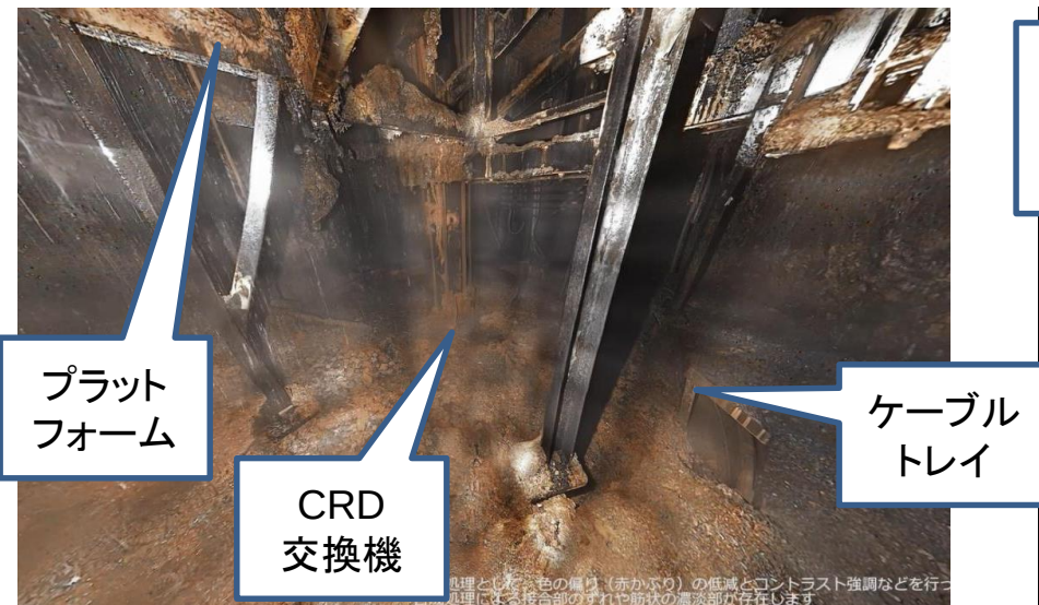
写真2. 2号機のペデスタル内の状況
