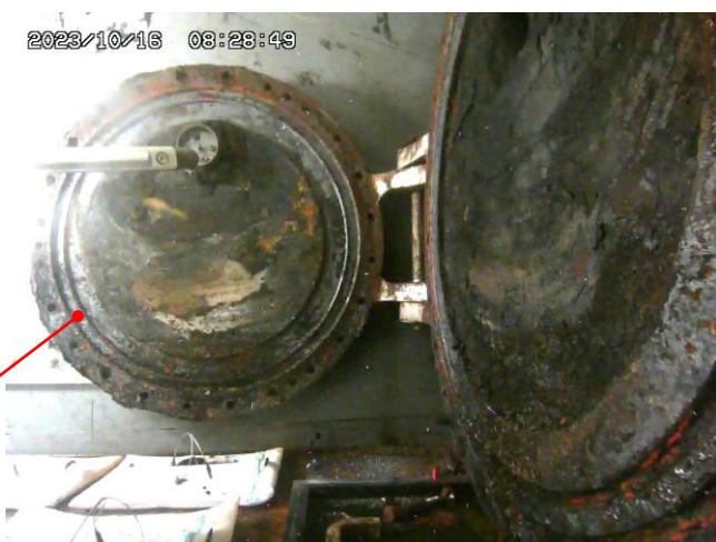
X-6ペネハッチ開放後(約90度) ※ペネを右から見た状況
