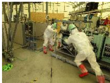
堆積物除去装置 （低圧水）設置
