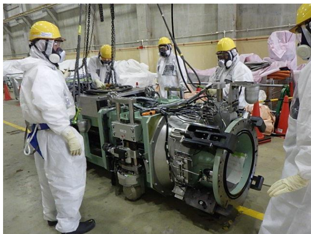
堆積物除去装置（低圧水）外観
