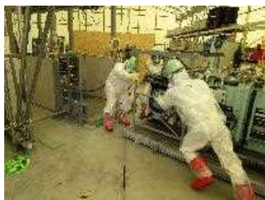
堆積物除去装置 (低圧水) 設置
