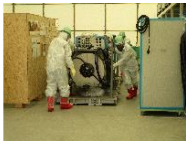
堆積物除去装置 (高圧水、AWJ) 設置
